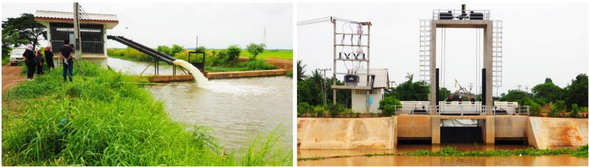
ภาพที่ 3: โรงสูบน้ำ หมู่ 1 บริเวณคลองสาน (ชาย) โรงสูบน้ำและประตูปิด-เปิดระบายน้ำ หมู่ 9 ปากคลองบางกุ้ง ตำบล บ้านกุ่ม อำเภอบางบาล (ขวา)
